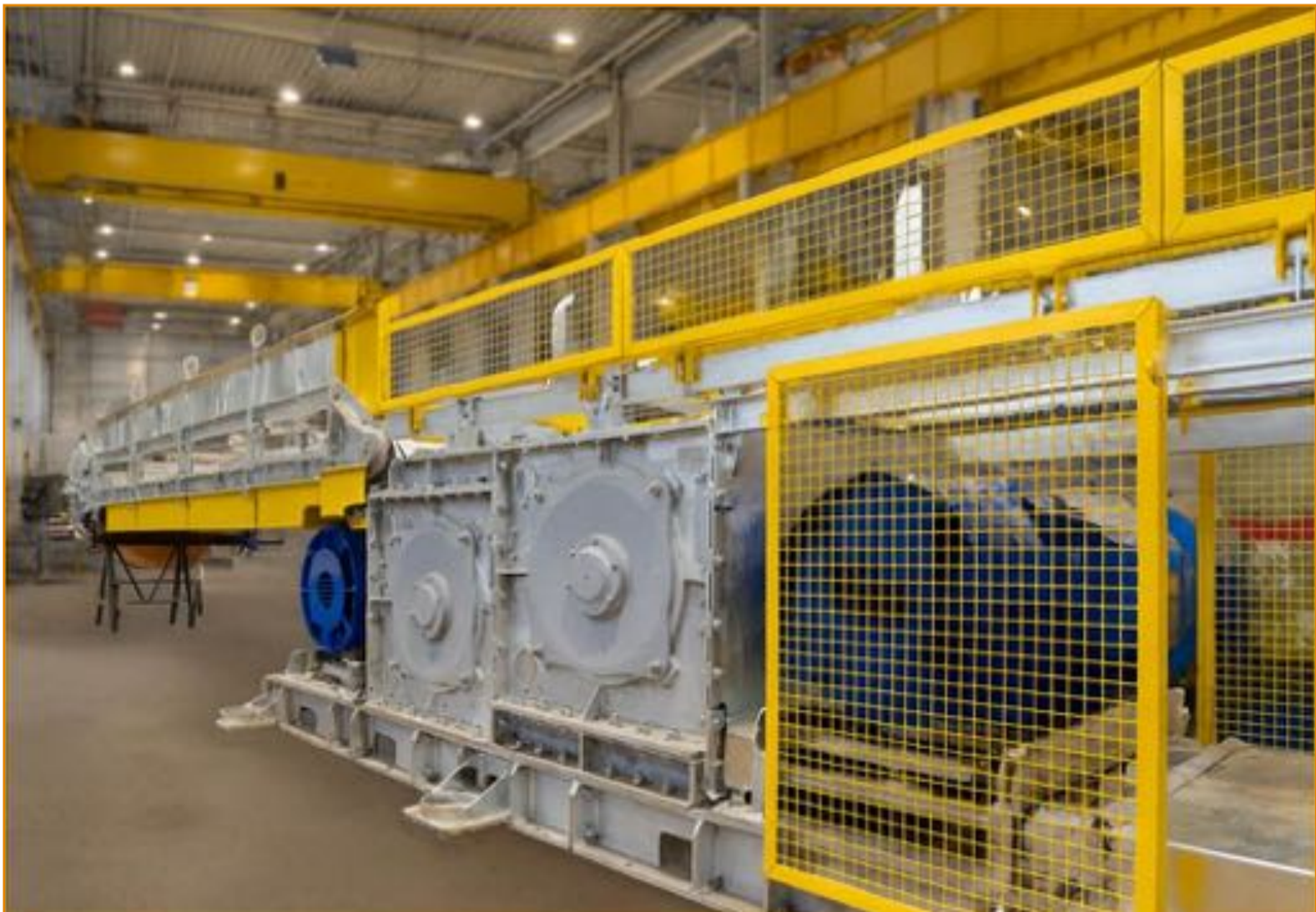
Rys. 1 Przenośnik taśmowy AR-Project 1000 - przenośnik o długości 150m przeznaczony do transportu urobku.
